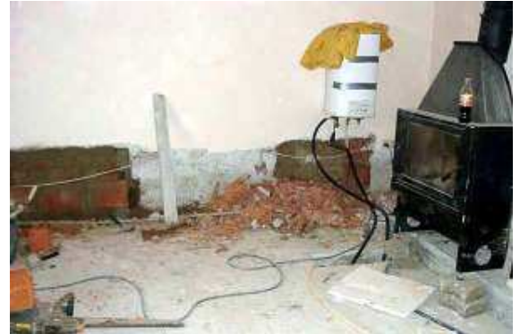
Ölschaden nach Hochwasser
